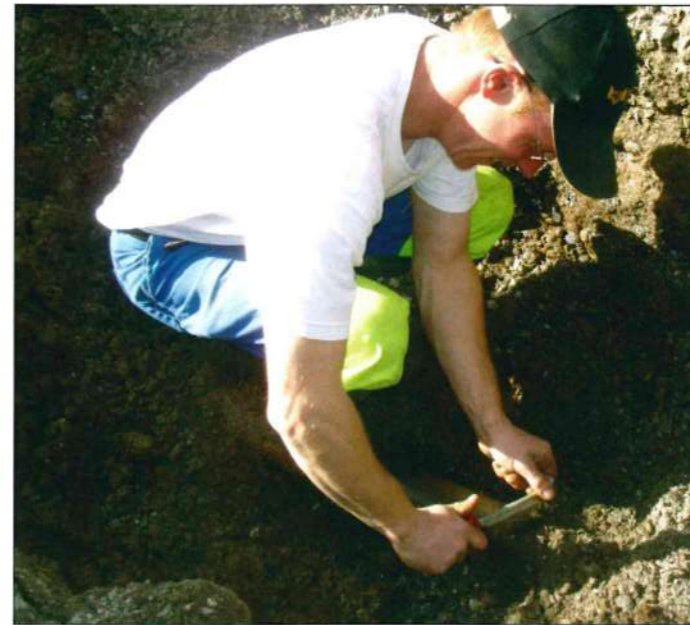
Recherche de fuite d'eau.
