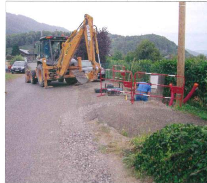
Route des Devants éclairage public
