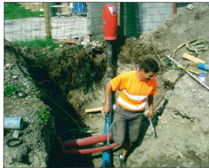
Branchement d'une borne incendie.
