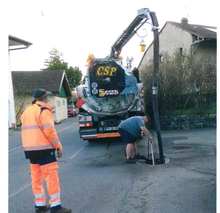
Currage annuel des grilles des eaux pluviales
