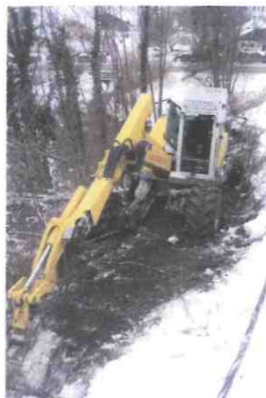
Enfouissement de la ligne HT sous la ravine
